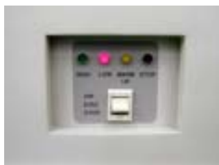
真空控制操作面板
